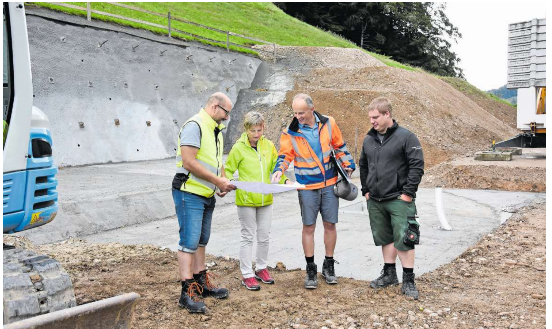
Auf Baustellenbesuch: Michel Honegger von der Firma Mock AG, Vreni Wild, Wasserkorporation Neckertal, Projektingenieur Patrick Naef von der Wälli AG sowie Landbesitzer Daniel Lieberherr (von links). Bild: Urs M. Hemm
